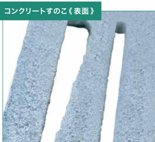
▲腐食により、溝の部分が広がってしまっている
