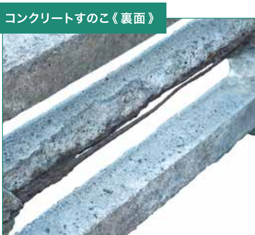
▲表面以上に腐食が激しく、鉄筋が見えてしまっている
